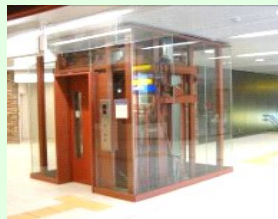
エレベーター
