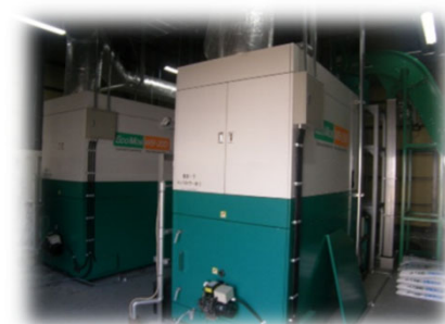
木質チップボイラ
