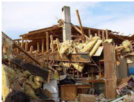
平成18年佐呂間町 竜巻被害調査
