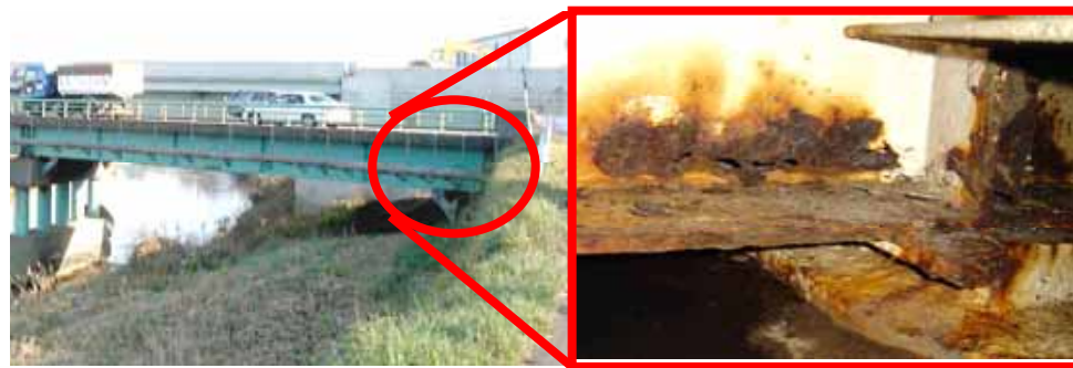
著しい腐食が見られる橋梁の事例
