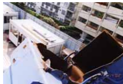
ブーム折損部
